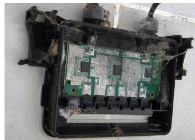
ダイオード故障 (目視確認は困難)
