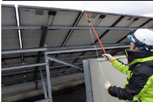
PVモジュールフレームの検電
