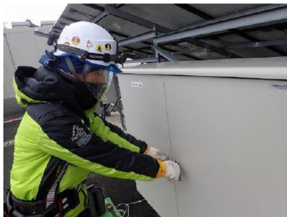
盤の扉を開けるときは保護面で顔面を保護
