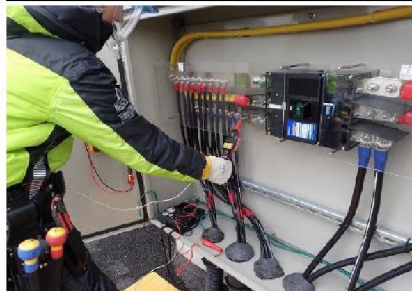
測定部を検電器で電圧の有無を確認する
