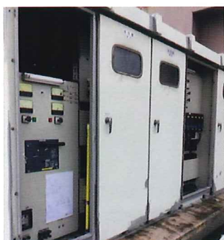
キュービクル扉破損 （暴風）
