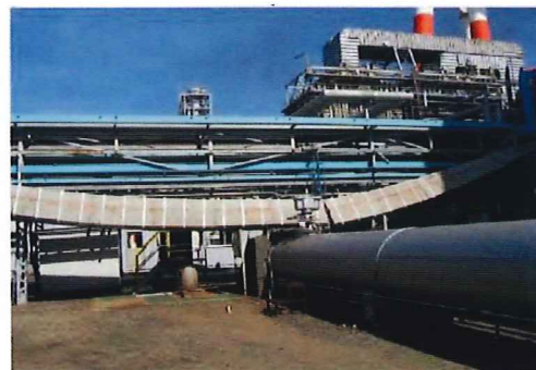
ケーブルダクトが架台から脱落
