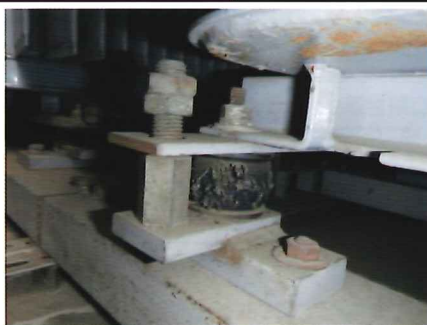
防振ゴム (劣化)
