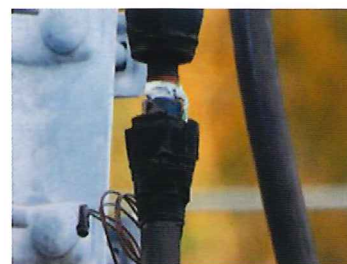
ケーブル内部露出
