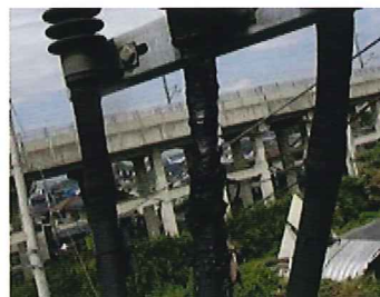
ケーブルヘッド焼損
