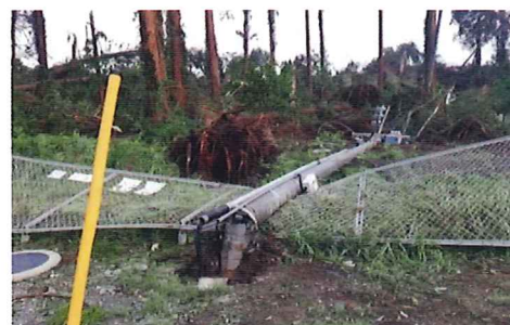
構内柱倒壊（暴風・倒木）
