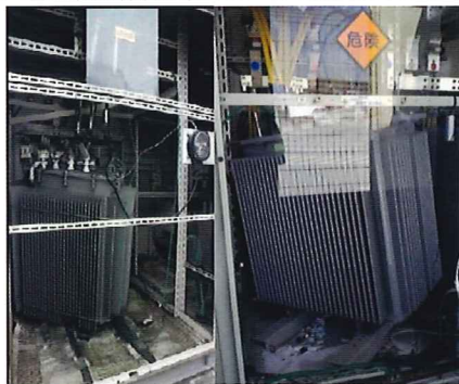
変圧器の移動・転倒
